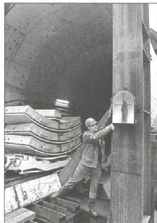
... beschermt ook in tunnels
